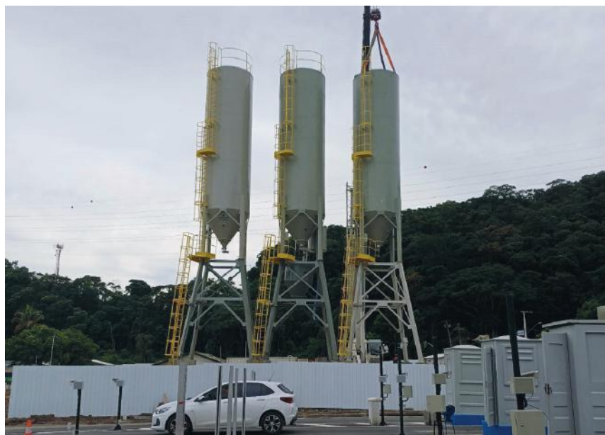
Silos de armazenamento de cimento. Imagem: CSPG.
