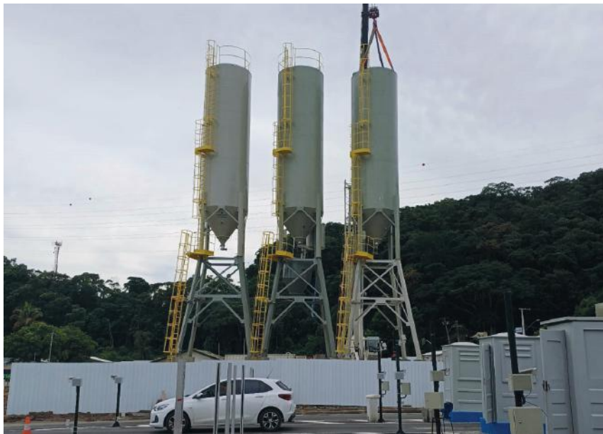
Silos de armazenamento de cimento. Imagem: CSPG.
